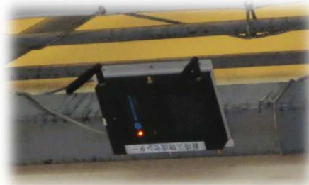
倉庫内アクセスポイント
